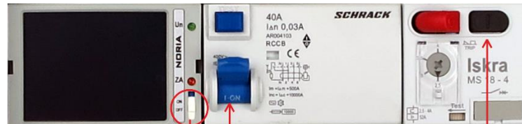
PREPNÚŤ DOLE ZÁLOŽNÁ AUTOMATIKA VYPNUTA PREPNÚŤ HORE HLAVNÝ VYPÍNAČ STLAČENÍM ZAPNÚŤ MOT. SPÍNAČ
